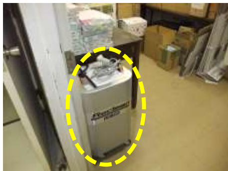
ドアを開けると左側にリチウム蓄電池
